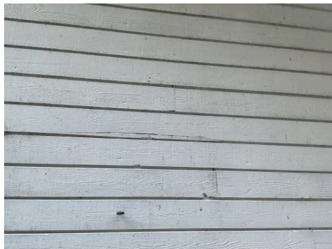
Det registreres sprekker i enkelte kledningsbord.
