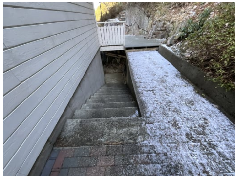
Mangler rekkverk langs trapp
