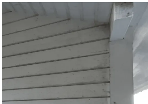
Det registreres sprekker i enkelte kledningsbord.
