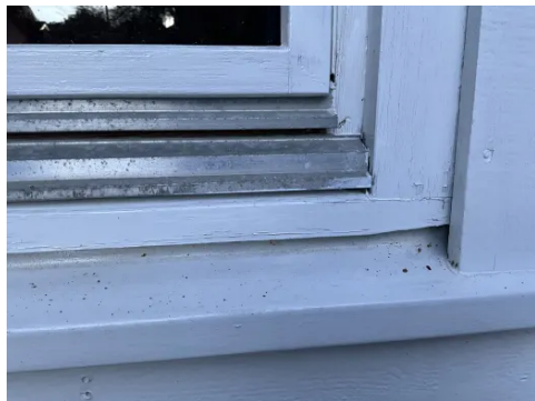
Utvendige karmen er noe værslitte
