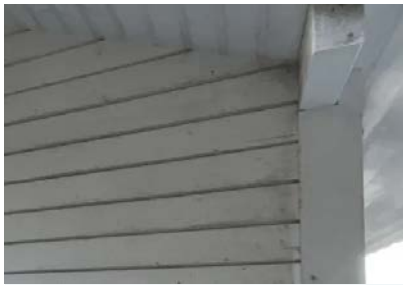
Det registreres sprekker i enkelte kledningsbord.
