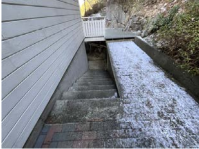
Mangler rekkverk langs trapp
