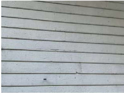
Det registreres sprekker i enkelte kledningsbord.
