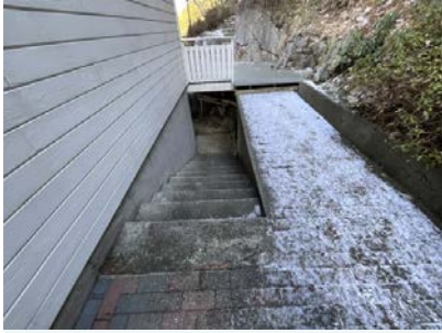
Mangler rekkverk langs trapp
