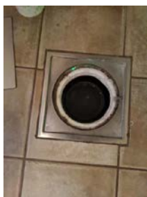
Tettesjiktets tilslutning til sluk - Sluk
