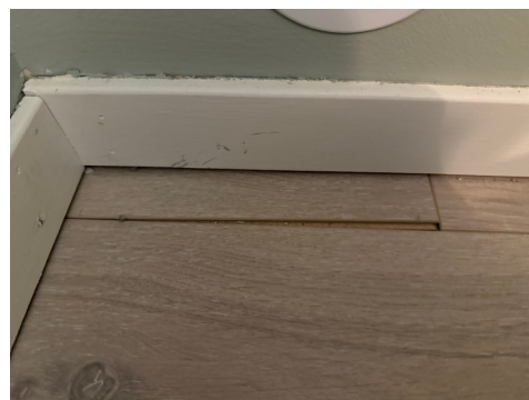
Glip i laminat v/ vegg mot bad på soverom 2.
