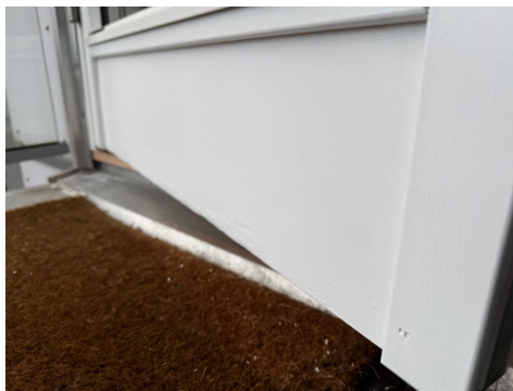
Noe slitasje i nedre del av altandør utvendig. Det bør vurderes å lime på et utvendig beslag da dette vil forlenge levetiden.
