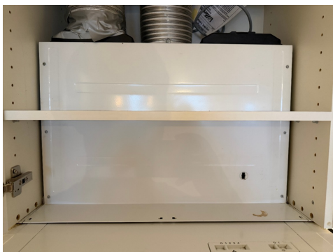
Ventilasjonsaggregat i kjøkkenskap.
