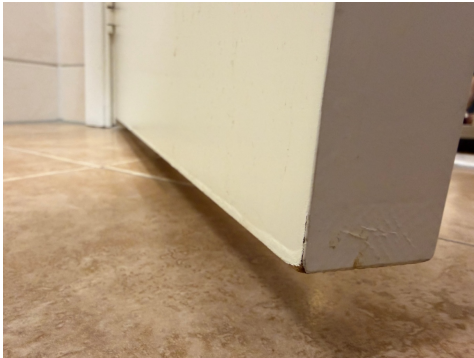
Fuktutsvelling/slitasje i nedre del av badedør.
