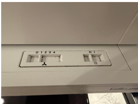
Bryterpanel på kjøkkenventilator. Bør stå på maks effekt v/ dusjing.
