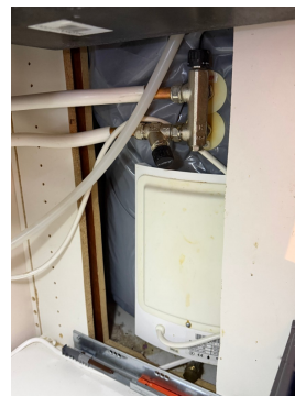
Varmtvannstank i kjøkkenskap.
