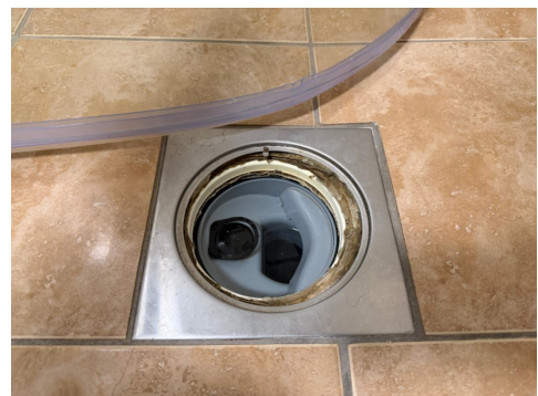
Plastsluk i dusjsone.
