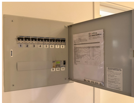
Sikringsskap i entre/gang.
