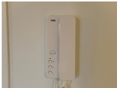
Dørtelefon i stue/kjøkken.
