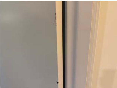
Slitasje på kant av innerdør mellom entre/gang - stue.
