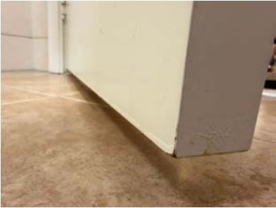
Fuktutsvelling/slitasje i nedre del av badedør.
