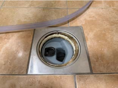
Plastsluk i dusjsone.
