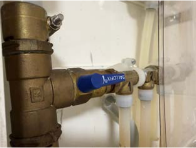
Stoppekran i rør i rør skap.
