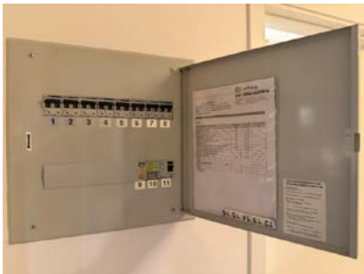
Sikringsskap i entre/gang.
