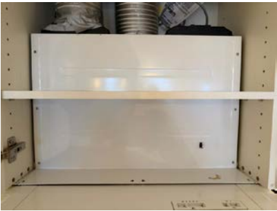
Ventilasjonsaggregat i kjøkkenskap.
