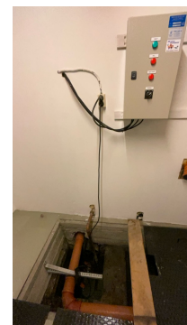
Kontroll av grunnvannskum med pumpe og flotør.
