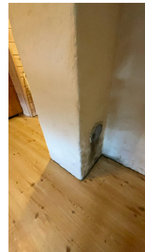
Manglende ildplate under feieluke.
