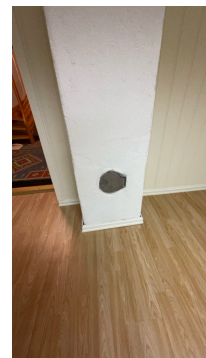
Manglende ildplate under feieluke.
