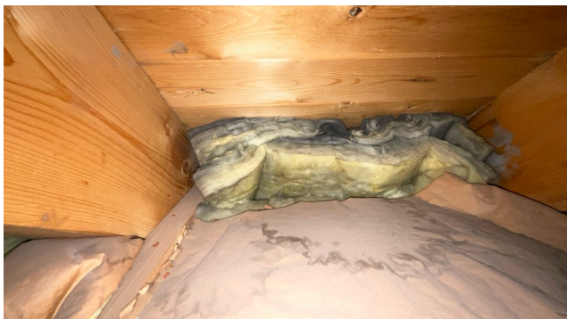
Minimalt med luftespalter på isolert del.
