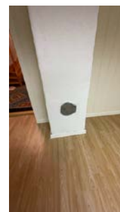
Manglende ildplate under feieluke.
