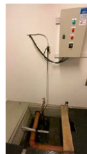
Kontroll av grunnvannskum med pumpe og flotør.
