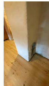
Manglende ildplate under feieluke.
