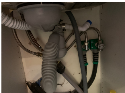
Røropplegget i kjøkken
