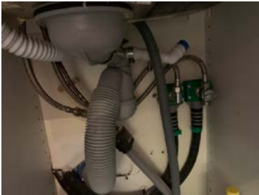
Røropplegget i kjøkken
