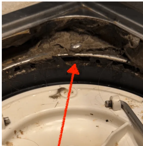
Glippe mellom klemring og sluk.
