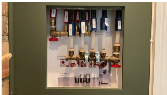
Rørskap med stoppekraner.
