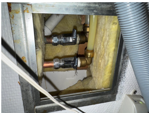
Hovedstoppekraner i benkeskap.
