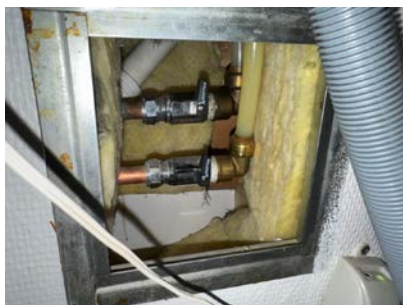
Hovedstoppekraner i benkeskap.
