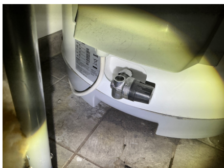
Drypper litt vann fra sikkerhetsventilen
