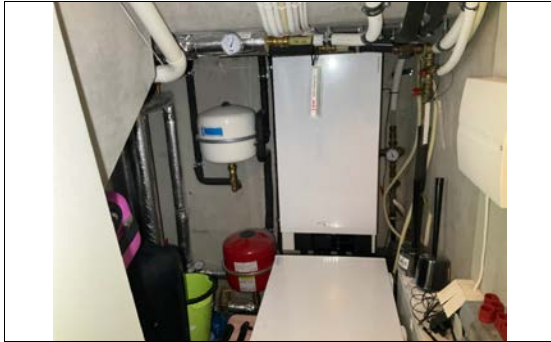
Teknisk rom med vannbårent varmeanlegg med varmtvannsproduksjon.
