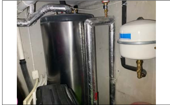
Teknisk rom med vannbårent varmeanlegg med varmtvannsproduksjon.
