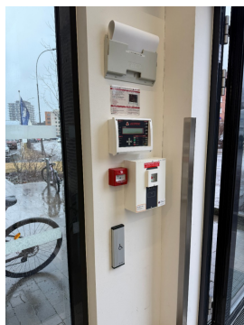
Felles brannvarslingsanlegg i bygget
