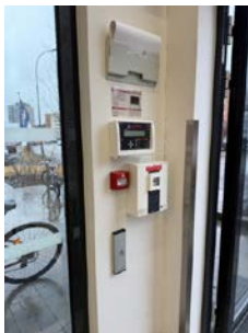
Felles brannvarslingsanlegg i bygget
