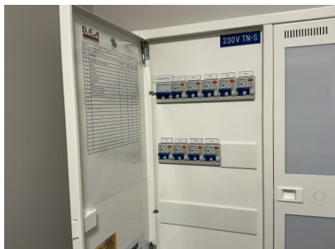
Sikringsskap plassert i omkleddningsrom
