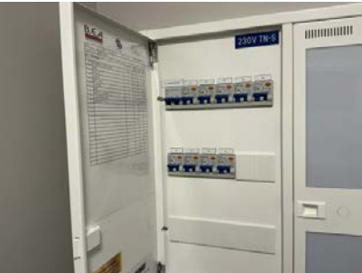
Sikringsskap plassert i omkledningsrom
