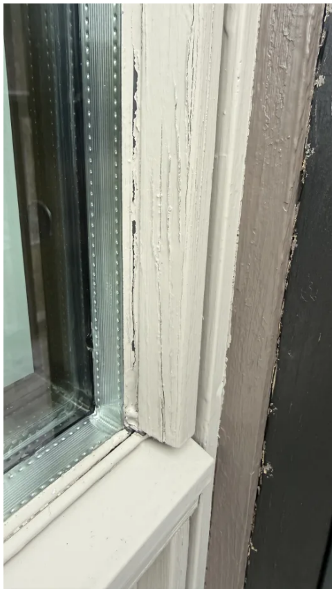
Eksempelbilde av påbegynt malingsavflass.
