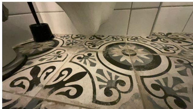
Lekkasjespalte på innebygget sistene bør opparbeides.
