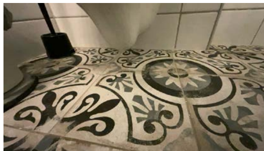
Lekkasjespalte på innebygget siste bør opparbeides.
