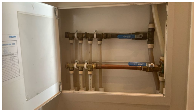
Rørskap med stoppekraner.
