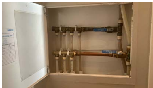
Rørskap med stoppekraner.
