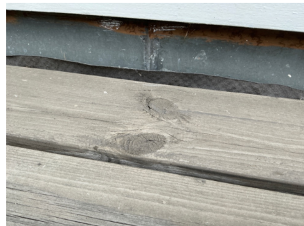
For lav og utett membranoppkant
