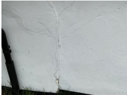
Sprekk og avflassing i betong
