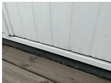
Sprekker i treverket.
