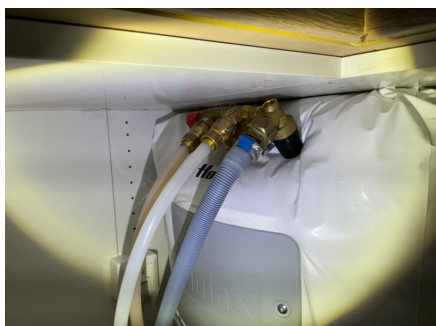
Plastrør mot bereder
