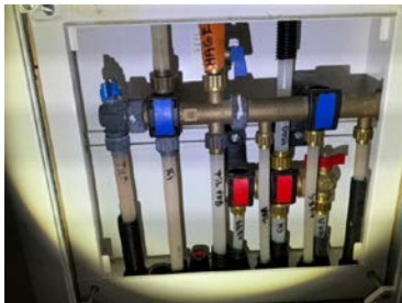
Mindre korrosjon i fordelerskap
