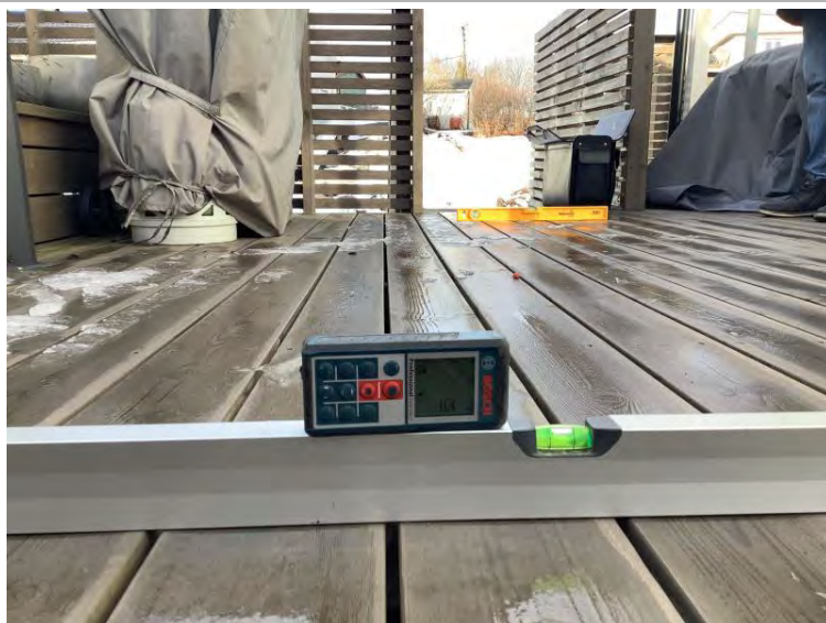
Terrasse i 1. Etasje: Mindre ujevnheter enkelte steder.
