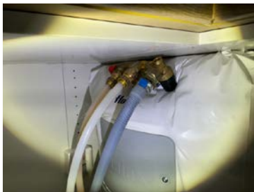
Plastrør mot bereder
