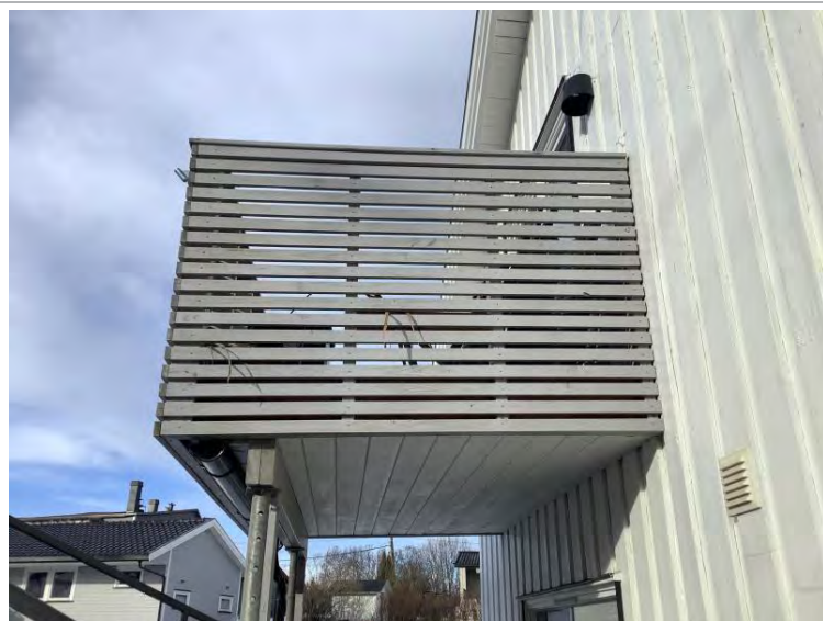
Noe større setningsskader/skjevheter på balkongen til naboen.
