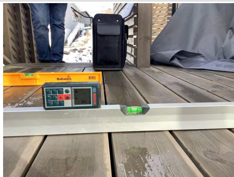
Terrasse i 1. Etasje: Mindre ujevnheter enkelte steder.
