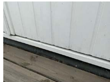
Sprekker i treverket.
