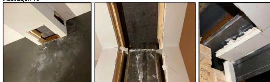
Illustrasjon 10 over, viser bilder fra 3 ulike knutepunkter for utveksling som bærer overliggende seksjon, her med manglende brannisolering.
