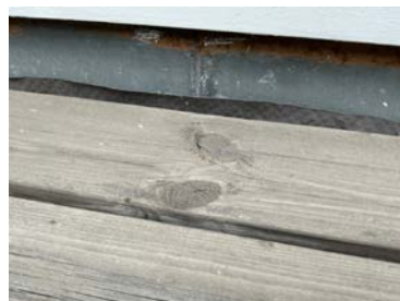
For lav og utett membranoppkant
