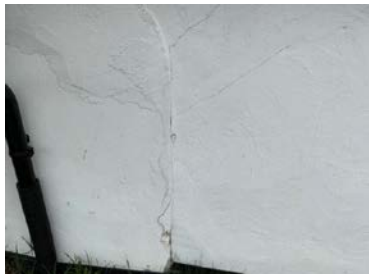
Sprekk og avflassing i betong
