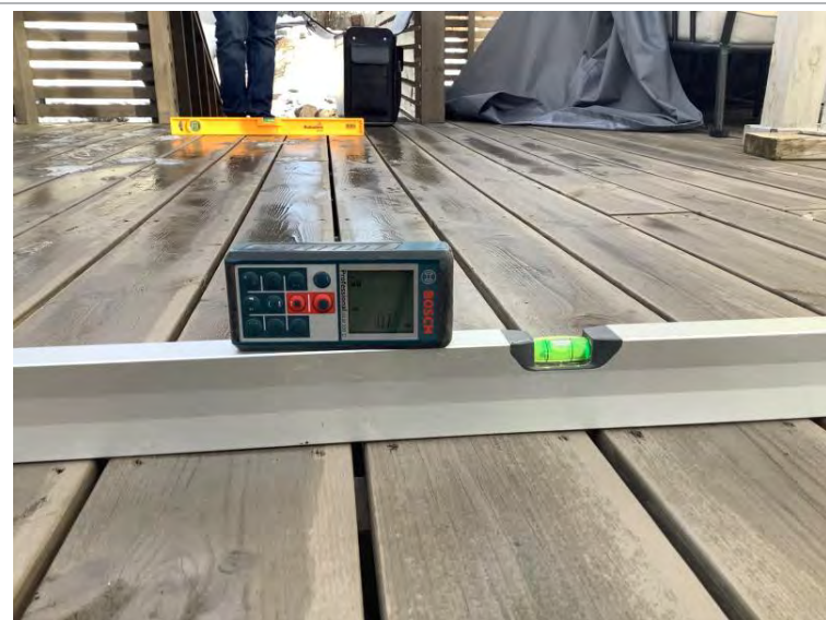
Terrasse i 1. Etasje: Mindre ujevnheter enkelte steder.
