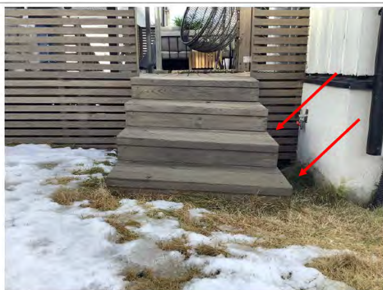
Trapp mot øst. Synlige skjevheter og manglende rekkverk.
