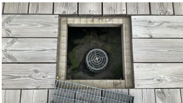
Sluk er tilgjengelig under luke i terrassen.
