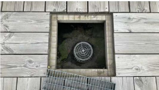
Sluk er tilgjengelig under luke i terrassen.
