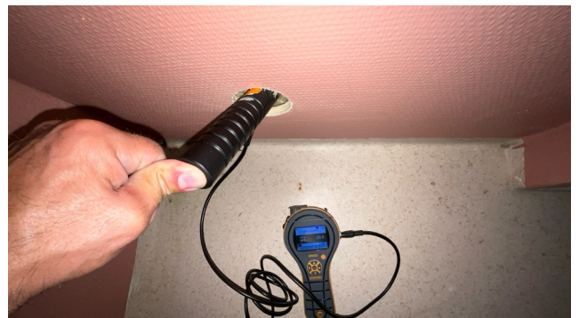
Utført hulltaking. Det er målt forhøyet fuktprosent der underliggende avvik ikke kan utelukkes.
