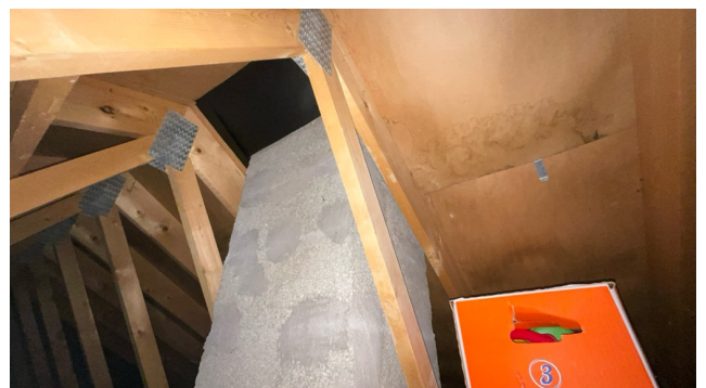
Kontroll rundt pipeløp. Utett overgang dog ingen synlige tegn til lekkasjer for øvrig på befaringdagen.
