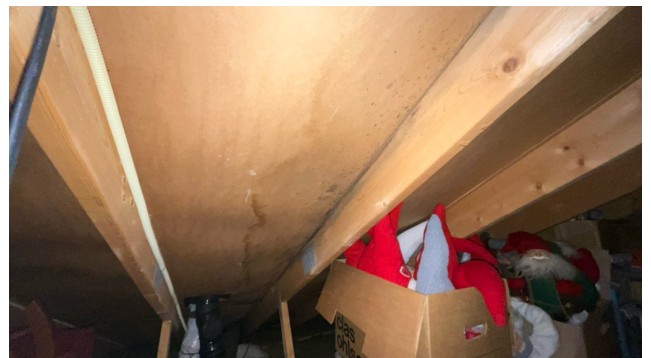
Synlig avvik på undertak over loftsluke der saneringsvask bør utføres.
