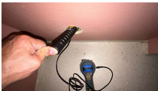
Utført hulltaking. Det er målt forhøyet fuktprosent der underliggende avvik ikke kan utelukkes.
