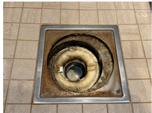
Plastsluk i dusjsone.
