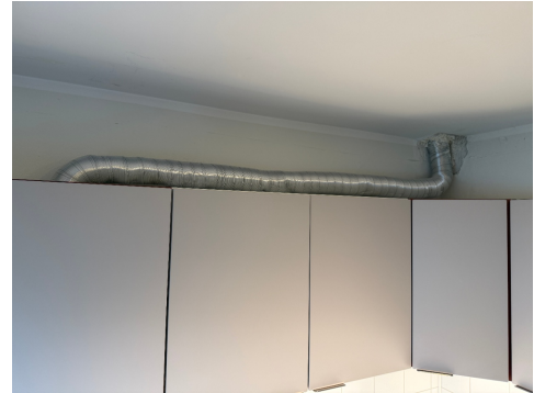
Synlig ventilasjonsrør over kjøkkenskap.
