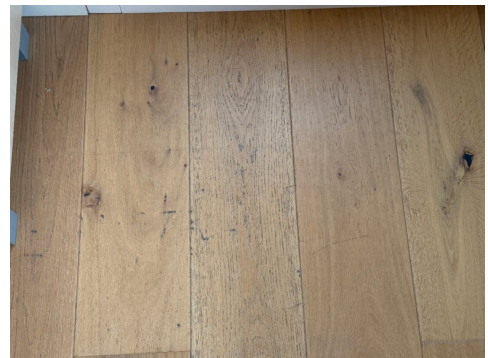
Slitasje/striper i parkettgulv.
