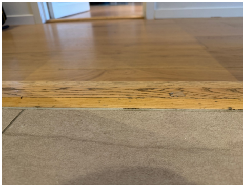
Ingen membranoppbrett v/ døråpning.
