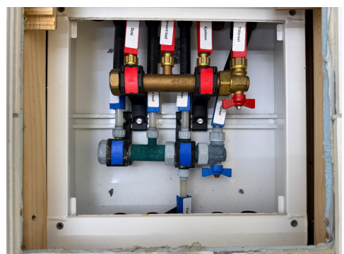
Irr på samlestokk i rør i rør skap.
