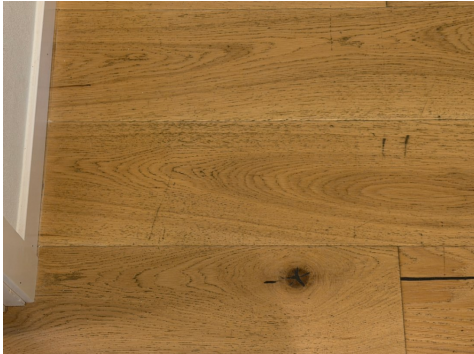
Slitasje/striper i parkettgulv.
