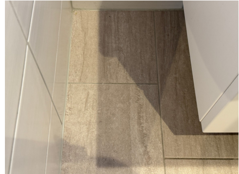
Bom ble registrert i enkelte gulvfliser, bla. i dette område.
