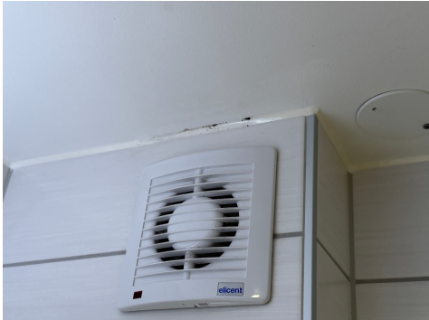
Svertesopp i silikonfuger.
