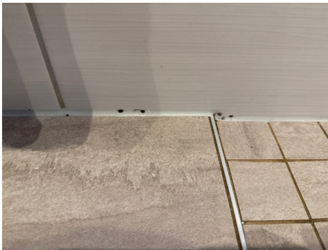
Svertesopp i silikonfuger.
