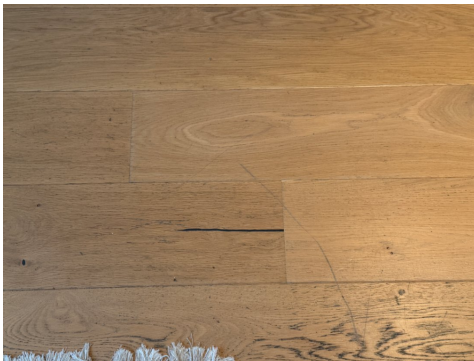
Slitasje/striper i parkettgulv.
