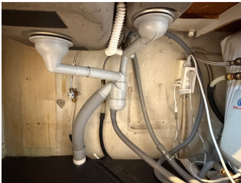
Røropplegg og aquastop under vask.
