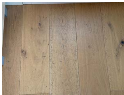
Slitasje/striper i parkettgulv.
