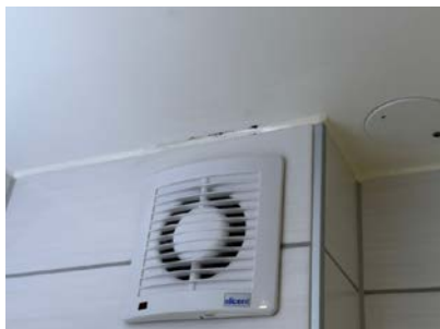
Svertesopp i silikofuger.
