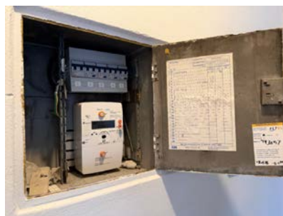
Sikringsskap i fellesarealer.
