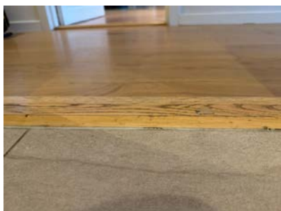
Ingen membranoppbrett v/ døråpning.
