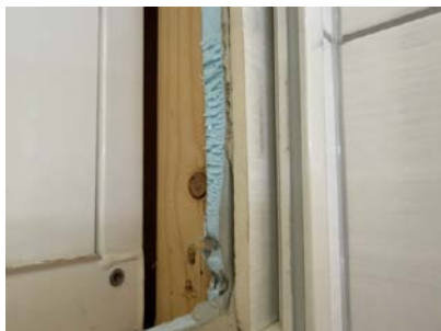
Synlig membranplate på vegg v/ rør i rør skap.
