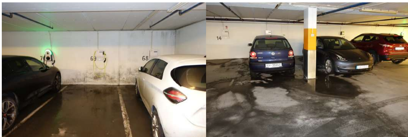
Stående vann mot vegg i garasjeanlegg.
