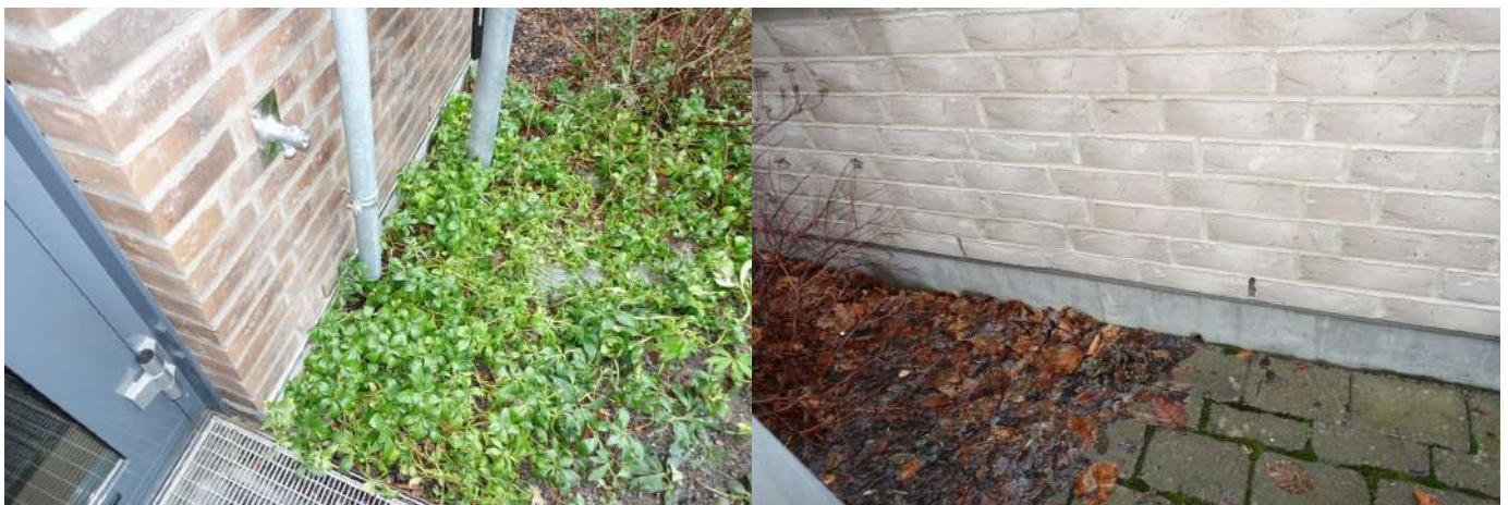
Fuktsikring av grunnmur mest sannsynlig bak sokkel beslag.
