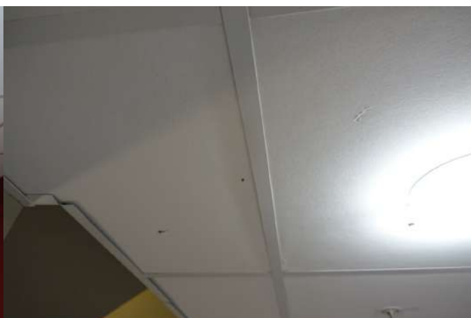
Himlingsplater med punktskader.
