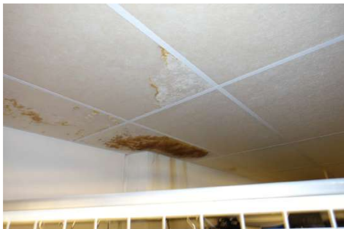
Himlingsplater med fuktskader.
