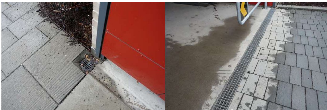
En type overvannsluk på eiendommen.
