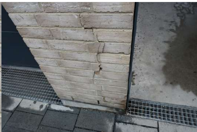
Eksempelbilde noe skader på teglfasade.
