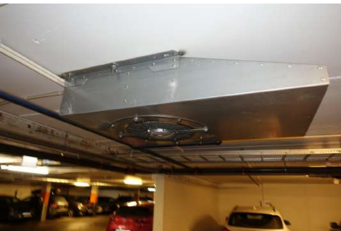
Mekanisk avtrekk for parkeringsanlegg.
