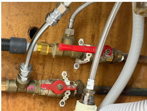
Stoppekraner i kjøkkenskap.
