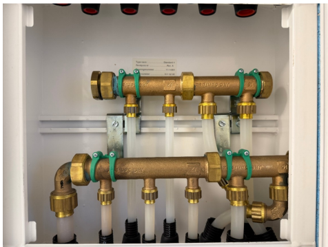
Ingen tegn til fukt/kondens i rør i rør skap. Rør i rør skap bør sjekkes for ev. lekkasje 2 ganger årlig.
