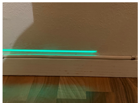
Bilder viser skjevheter i gulv på det ene soverommet.
