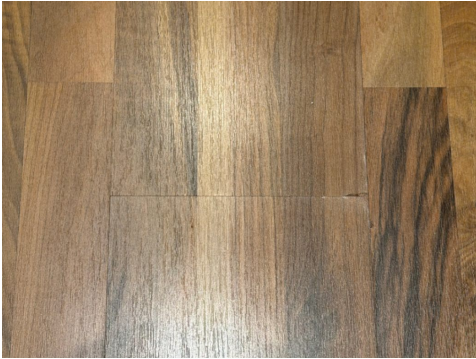
Fuktutsvelling i laminatskjøter i entre/gang.
