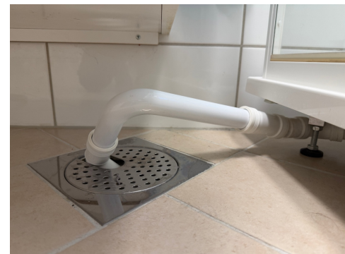
Avløpsrør fra dusjkabinett til sluk.
