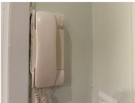
Dørtelefon i entre/gang.
