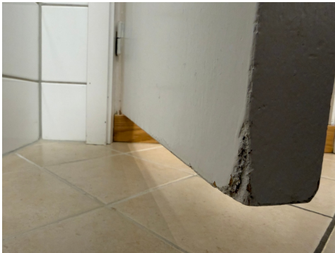
Fuktutsvelling/slitasje i nedre del av badedør.
