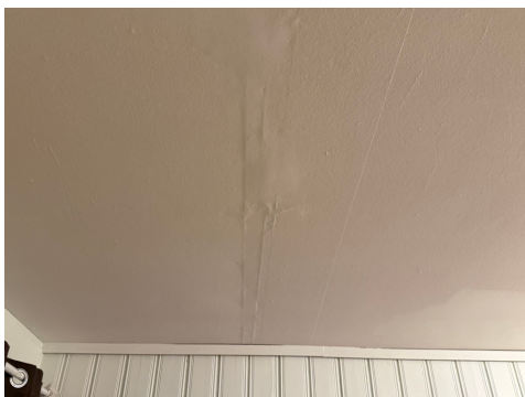
Ujevne overflater i himling på soverom.
