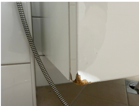
Fuktutsvelling i nedre del av baderomsinnredning.
