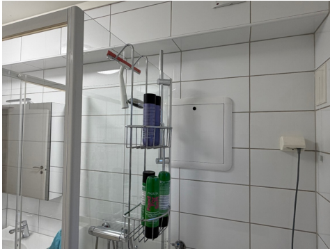
Rør i rør skap i våtsone.
