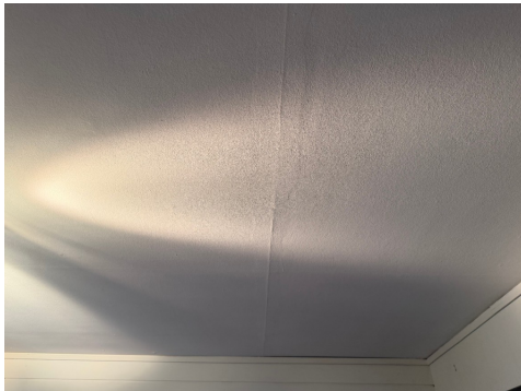
Ujevne overflater i himling på soverom.
