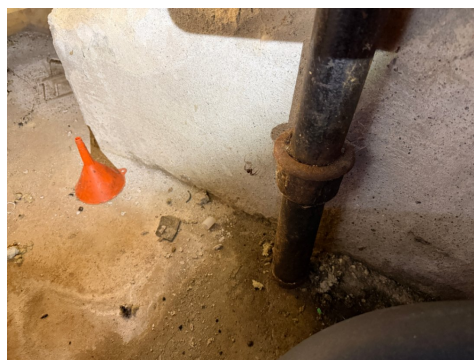
Rust på eldre avløpsrør i u-etg.
