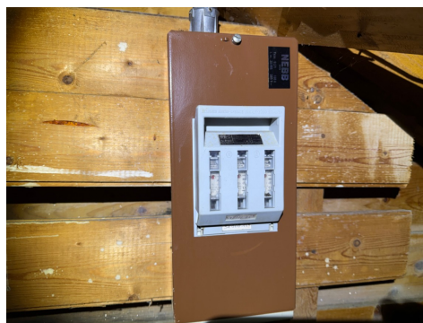
Felles inntaksikring på koffertloft.
