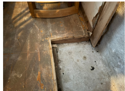
Oppforet tregulv i fellesarealer i u-etg. Må anses å være en risikokonstruksjon. Oppforet tregulv bør fjernes, spesielt v/ en oppgradering.
