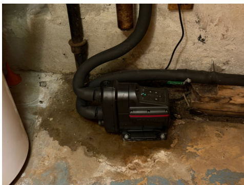
Fukt rundt trykktank i u-etg.
