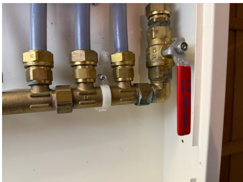
Stoppekran i rør i rør skap.
