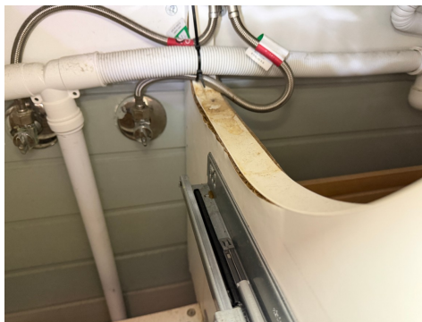
Fuktutsvelling i baderomsinnredning.
