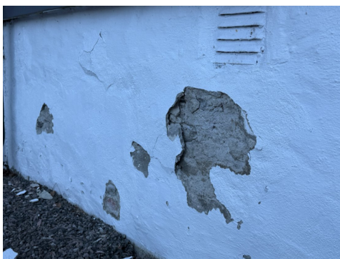
Løs puss på grunnmur.
