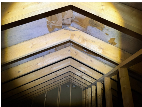
Kondens og frost på undside av sutak.
