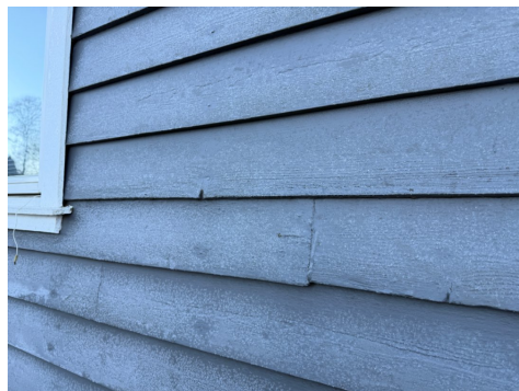
Slitasje og væroppsprukke kledningsbord utenfor kjøkkendel.
