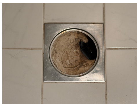
Eldre plastsluk i dusjsone.
