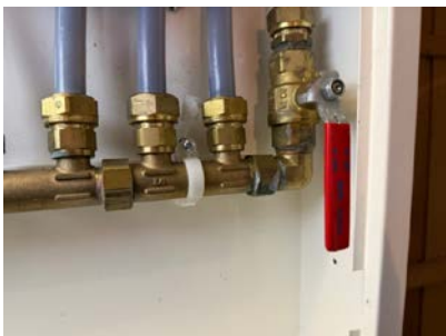
Stoppekran i rør i rør skap.
