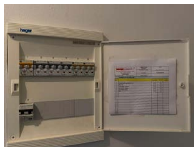
Sikringsskap i gang.
