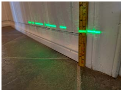
Bilder viser skjevheter i gulv i gang.
