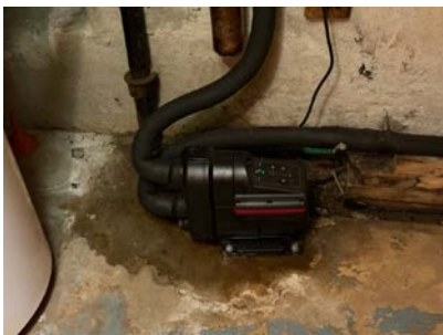
Fukt rundt trykktank i u-etg.
