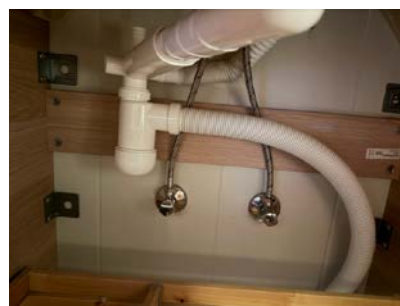
Rørøpplagg under servant.
