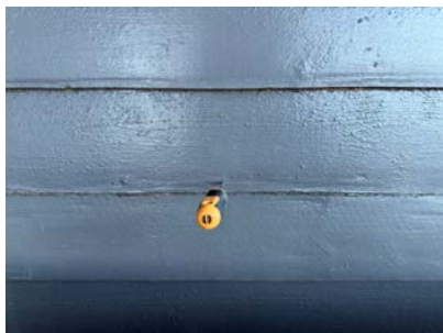
Råteskader i kledningsbord v/ terrasse.
