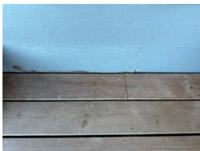
Ingen beslag i overgang kledning - terrasse.
