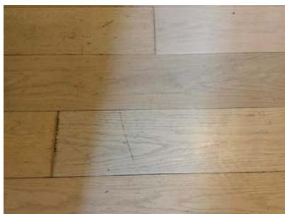
Slitasje/striper i parkettgulv i entre/gang.
