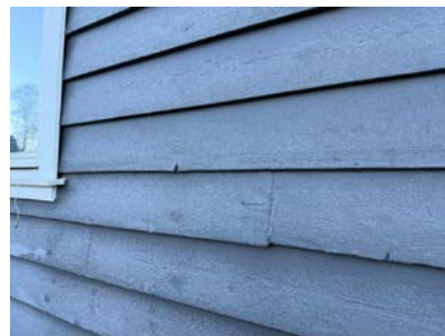
Slitasje og værøppsprukkede kledningsbord utenfor kjøkkendel.
