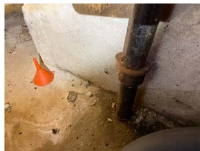
Rust på eldre avløpsrør i u-etg.
