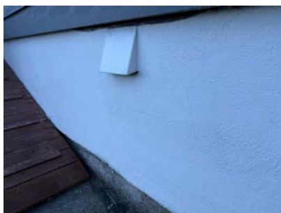
Ventil i grunnmur indikerer at det er krypkjeller under det ene soverommet.
