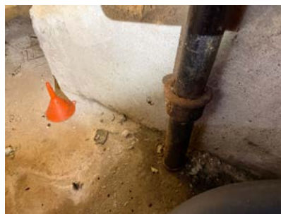
Rust på eldre avløpsrør i u-etg.
