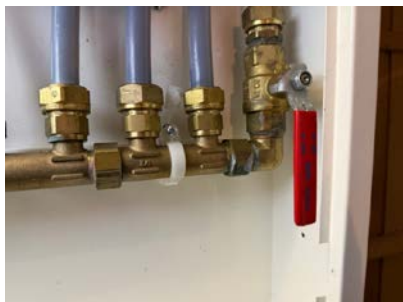
Stoppekran i rør i rør skap.
