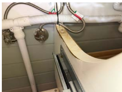
Fuktutsvelling i baderomsinnredning.
