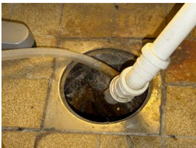
Eldre støpejernsluk i gulv i innredet bod. Innredet bod fremstår med eldre standard og generell oppgradering og utbedringer må påregnes.
