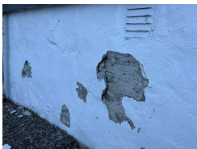
Løs puss på grunnmur.
