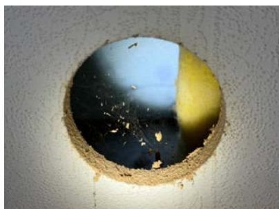
Synlig del av veggkonstruksjon etter hulltaking. Det er montert hvit blindlokk etter hulltaking.
