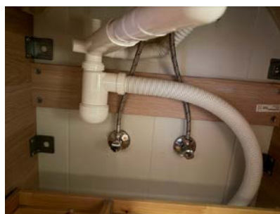
Rørøppløkk under servant.
