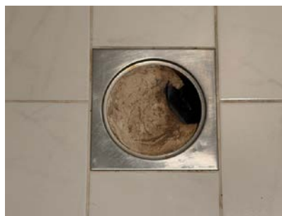
Eldre plastsluk i dusjsone.
