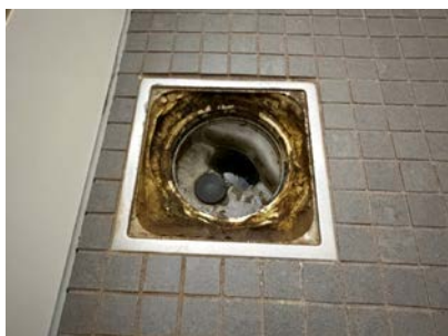
Plastsluk i dusjsone.
