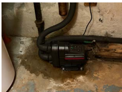
Fukt rundt trykk tank i u-etg.
