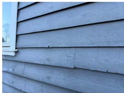
Slitasje og værøppsprukkede kledningsbord utenfor kjøkkendel.
