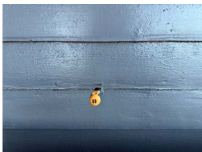
Råteskader i kledningsbord v/ terrasse.
