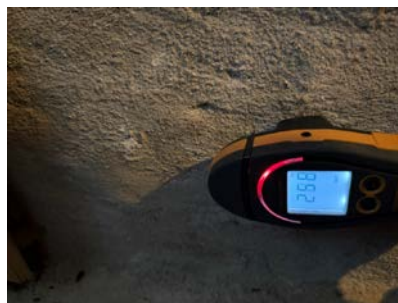
Forhøyede fuktverdier på innside av grunnmur i u-etg.
