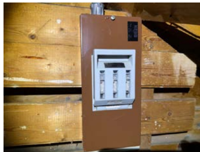
Felles inntaksikring på koffertloft.
