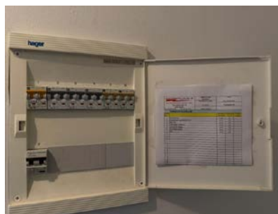
Sikringsskap i gang.
