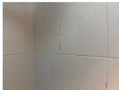
Noe malingsflis på veggfliser.
