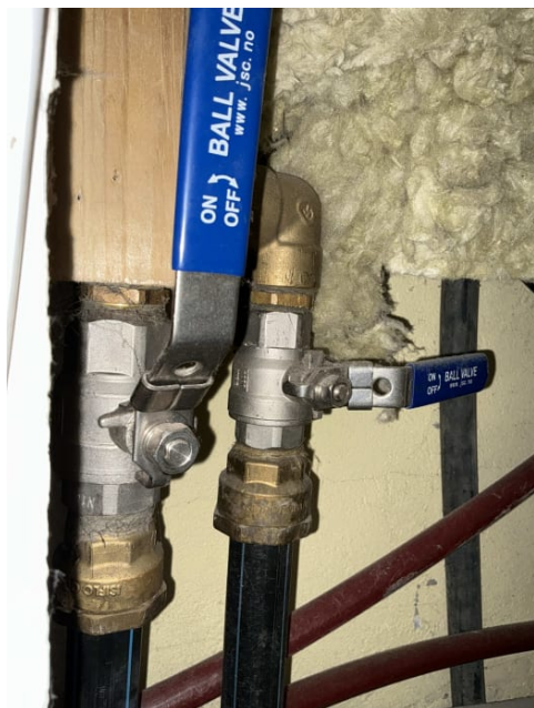
Stoppekran på teknisk rom.
