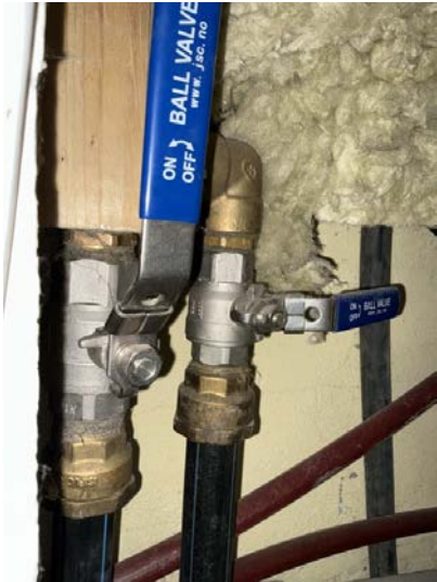
Stoppekran på teknisk rom.
