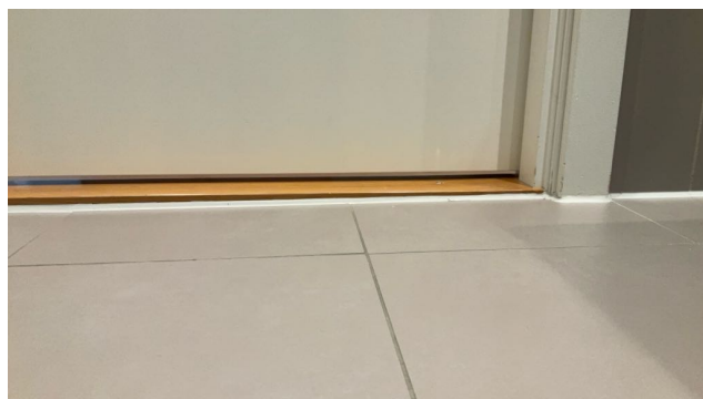
Overstrømming under døren.
