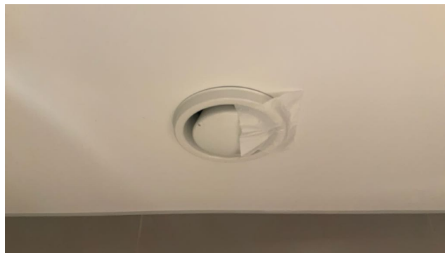
Test av avtrekk. Papiret henger.
