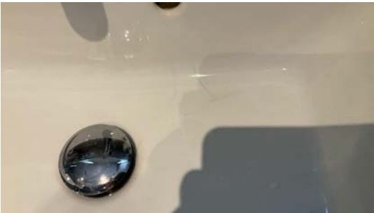
Noe mindre krakillering i emaljen i servanten.
