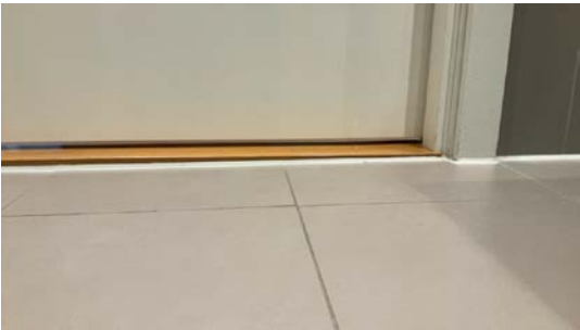
Overstrømming under døren.
