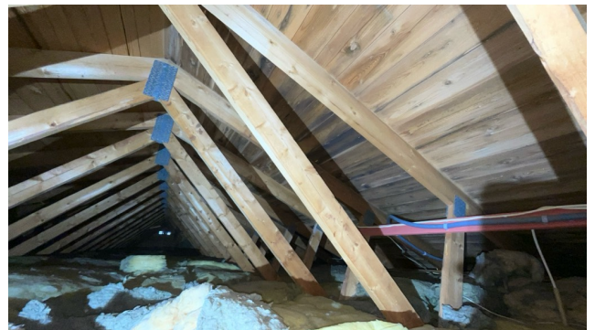
Stedvis misfarget undertak.
