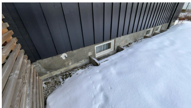
Stedvis behov for lokale utbedringer.
