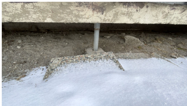
Utbedringer/forsterkninger av fundamenter er påregnelig.
