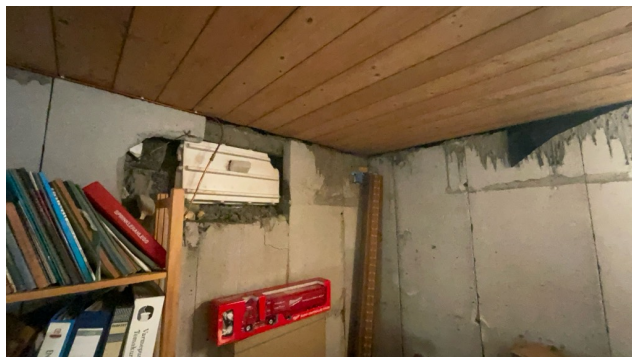
Stedvis behov for lokale utbedringer.
