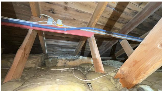
Stedvis misfarget undertak.
