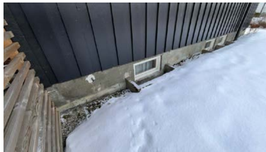
Stedvis behov for lokale utbedringer.
