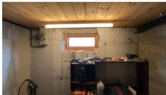
Stedvis behov for lokale utbedringer.
