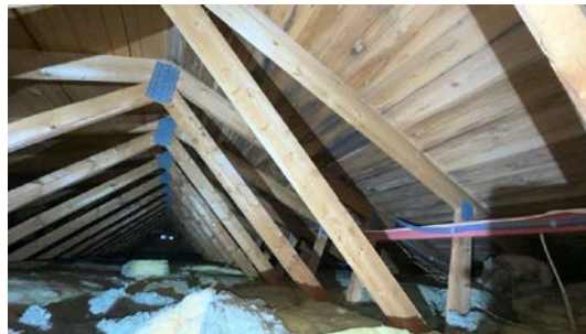
Stedvis misfarget undertak.
