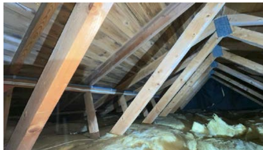
Stedvis misfarget undertak.
