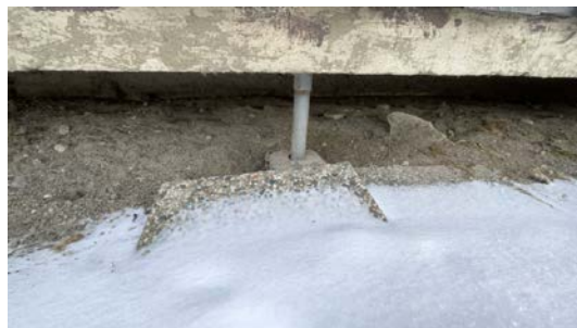
Utbedringer/forsterkninger av fundamenter er påregnelig.
