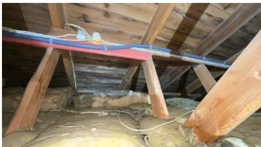
Stedvis missfarget undertak.
