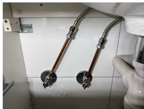
Røropplegg i servantskap
