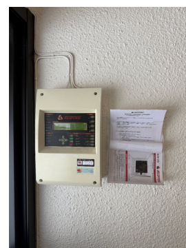
Felles brannvarslingsanlegg i bygget
