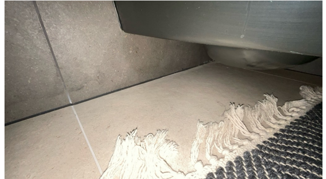
Lekkasjespalte på innebygget sistene bør opparbeides.
