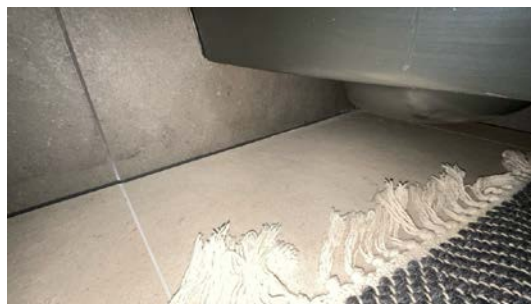
Lekkasjespalte på innebygget sistene bør opparbeides.
