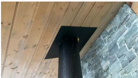
Kontroll rundt pipeløp. Noe tegn til tidligere kondens.
