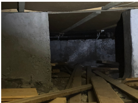
Saltutslag på innside av grunnmur i krypkjeller.
