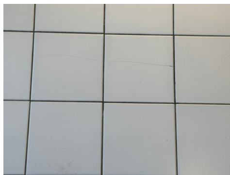
Sprekker i gulvfliser.
