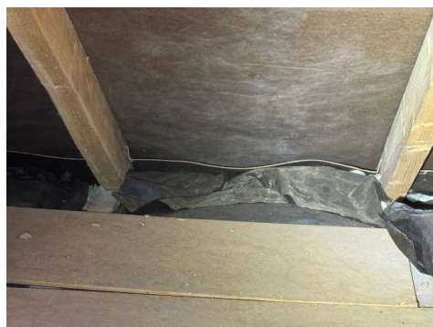
Fuktskjolder/misfarging i sutak. Liten luftespalte i nedre del.
