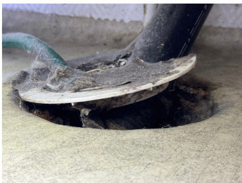
Eldre plastsluk i gulv.
