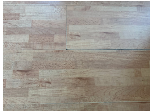
Fuktutsvelling i laminatskjøter.
