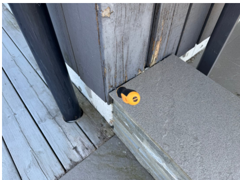
Lokal råte i nedre del av kledningsbord.
