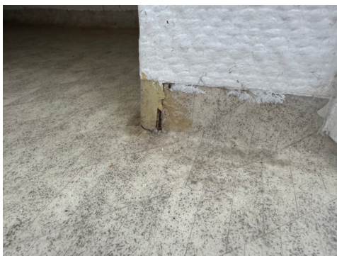
Rift i oppbrett på våtromsbelegg.
