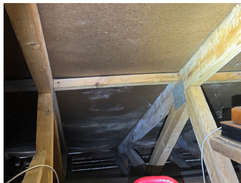
Fuktskjolder/misfarging i sutak.
