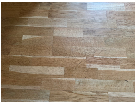
Slitasje/striper i parkettgulv.
