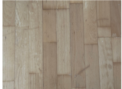
Slitasje/striper i parkettgulv.
