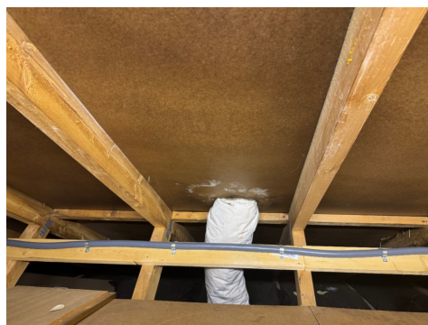
Fuktskjolder/misfarging i sutak.
