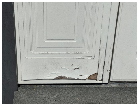
Fuktutsvelling i nedre del av ytterdør.
