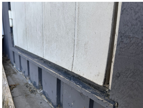
Fuktutsvelling i nedre del av ytterdør.
