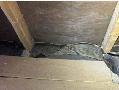
Fuktskjolder/misfarging i sutak. Liten luftespalte i nedre del.
