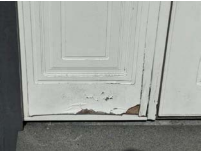
Fuktutsvelling i nedre del av ytterdør.
