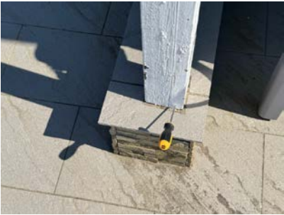
Lokal råte i nedre del av søyle v/ terrasse.
