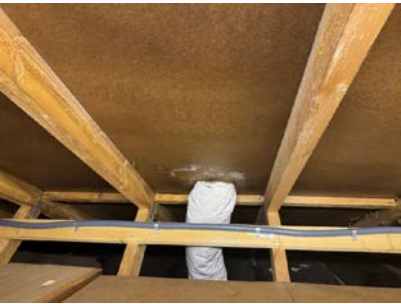
Fuktskjolder/misfarging i sutak.
