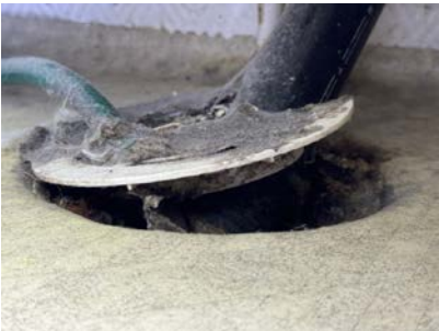
Eldre plastsluk i gulv.
