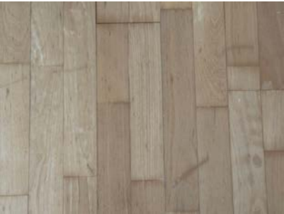
Slitasje/striper i parkettgulv.
