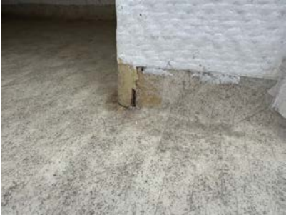
Rift i oppbrett på våtromsbelegg.
