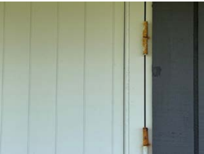
Rust på hengsler til terrassedør på soverom.
