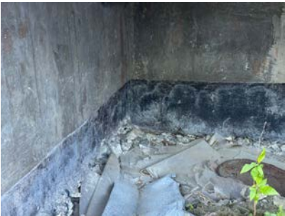
Synlig hydong/asfaltmasse inntil grunnmuren.
