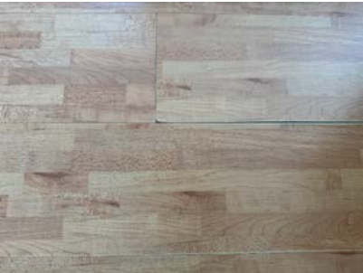
Fuktutsvelling i laminatskjøter.
