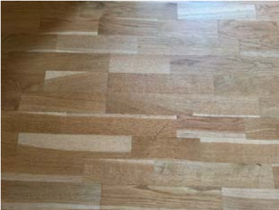
Slitasje/striper i parkettgulv.
