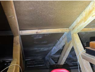
Fuktskjolder/misfarging i sutak.
