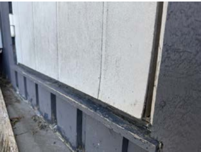
Fuktutsvelling i nedre del av ytterdør.
