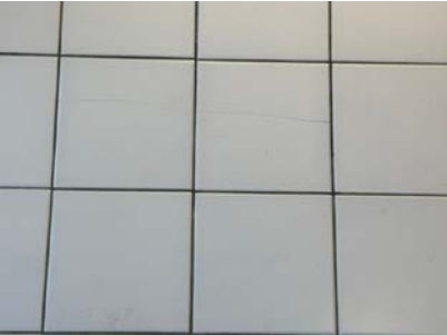
Sprekker i gulvfliser.
