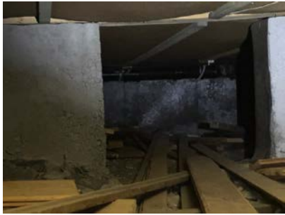
Saltutslag på innside av grunnmur i krypkjeller.
