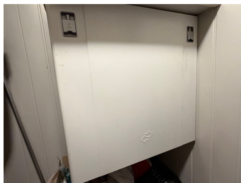
Luftbehandlingsaggregat i bod/teknisk rom.
