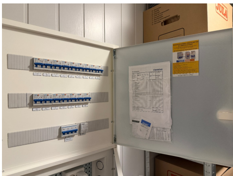
Sikringsskap i bod/teknisk rom.
