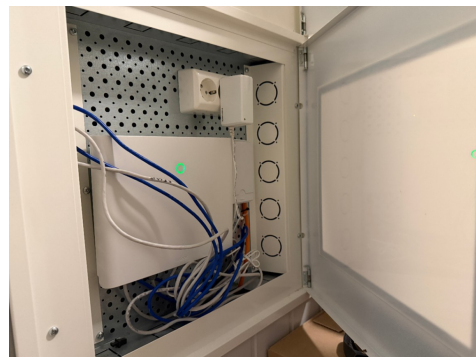
Nettverksdel under sikringsskap.
