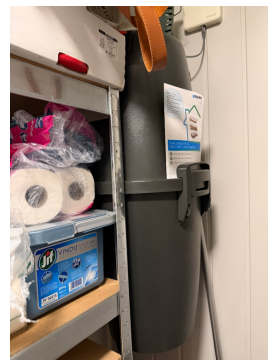
Sentralstøvsuger i bod/teknisk rom.
