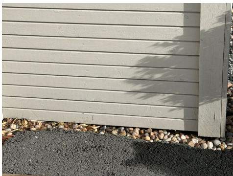
Liten avstand mellom bordkledning - terreng v/ inngangsparti.
