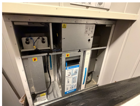
Luftbehandlingsaggregat bak deksel.
