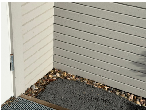
Liten avstand mellom bordkledning - terreng v/ inngangsparti.
